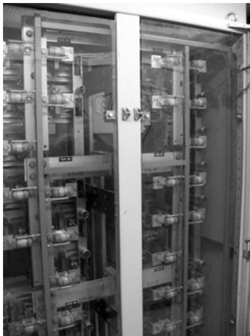
Fig.6 Öppet likriktarskåp i likriktarstation
