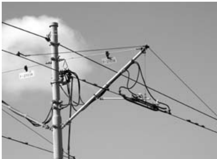
Fig.5 Isolerskarv på kontaktledning.
