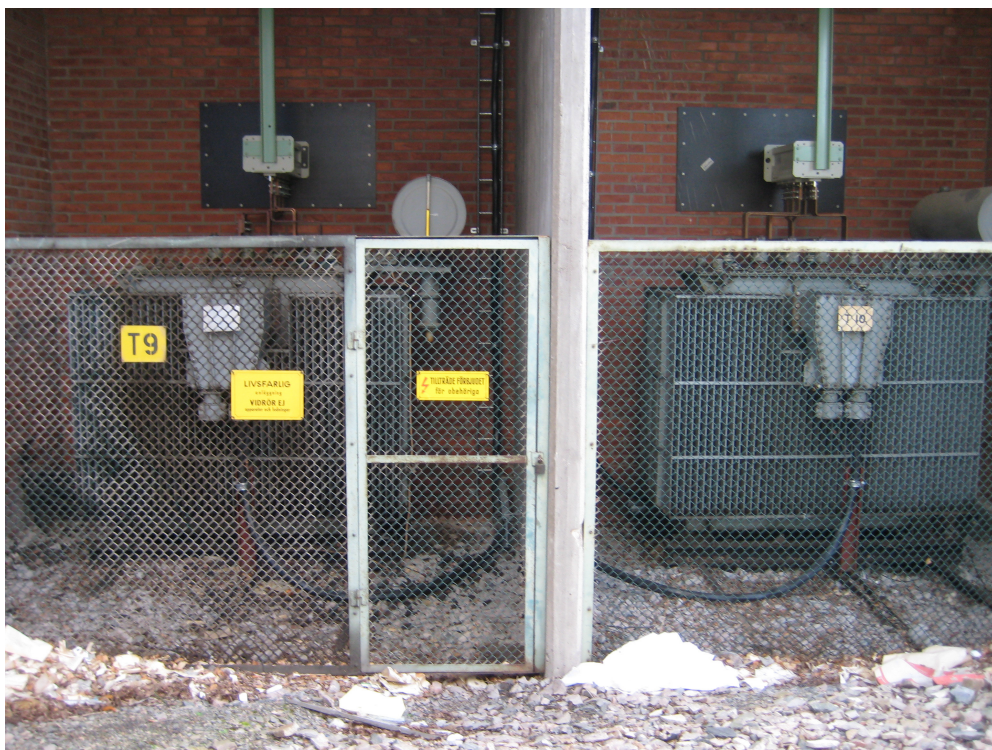
Figur 21. Transformator T9 och T10 sett utifrån.
