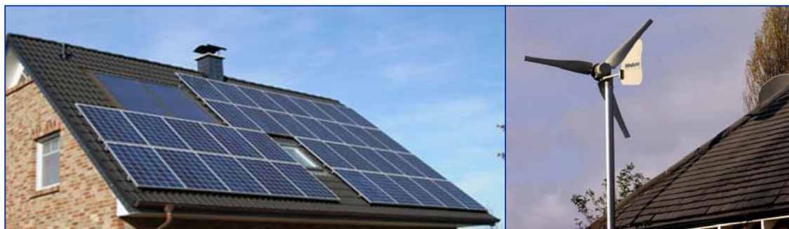
Figur 15: Solceller och vindkraftverk anslutna till lågspänningsnätet.
