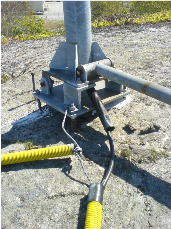
Figur 3.3 Fundamentet till vindmasten. Här syns även att åskledarlinan är ansluten till fundamentet samt elkabeln som går upp i tornet.
