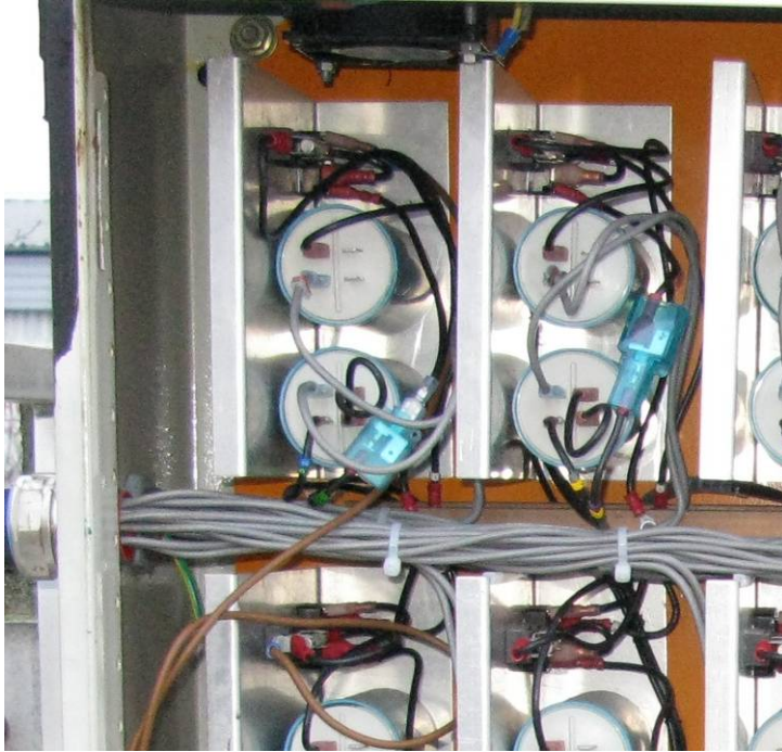
Fig. 2.9: Detaljbild ur likriktarskåpet. På varje plåtvinkel sitter diodlikriktare, säkring och (urkopplade) parallellkondensatorer för en generatormodul. Det gråa kabelknippet kommer från en seriekondensatorlåda. Under seriekondensatorkablarna syns kopparskenor där den likriktade spänningen från de olika modulerna kopplas samman.
