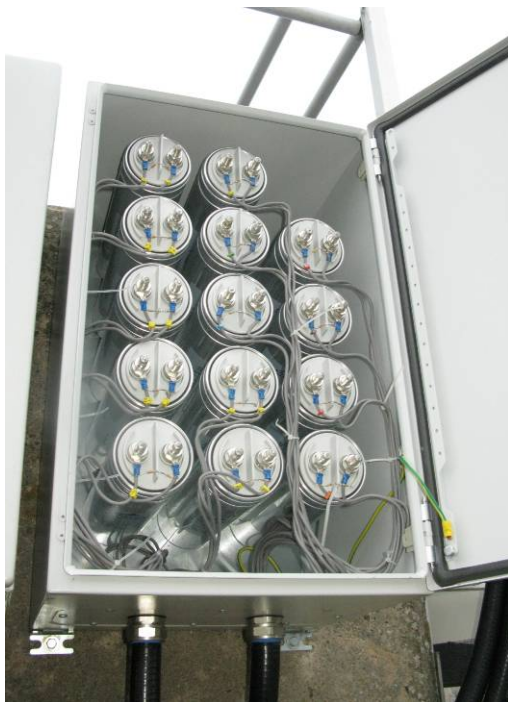
Fig. 2.8: Innehållet i ett av de två skåpen med seriekompenseringskondensatorer.
